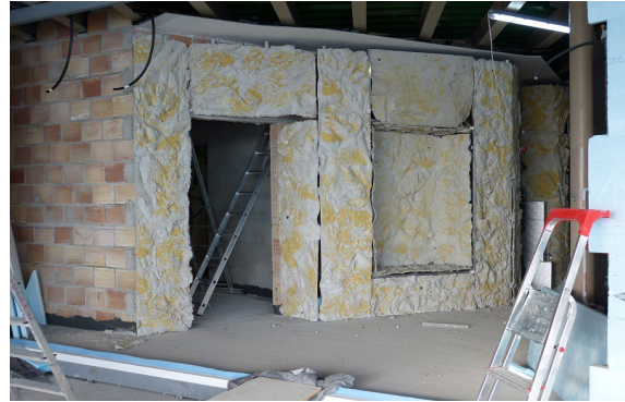
Spalte zwischen den Platten ca. 1-2 cm
